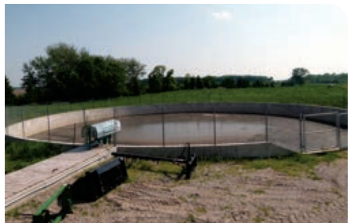
Figure 42. Structure non couverte, au-dessus du sol, à parois verticales, pour l'entreposage du fumier liquide et rampe d'accès pour le nettoyage (M1)
