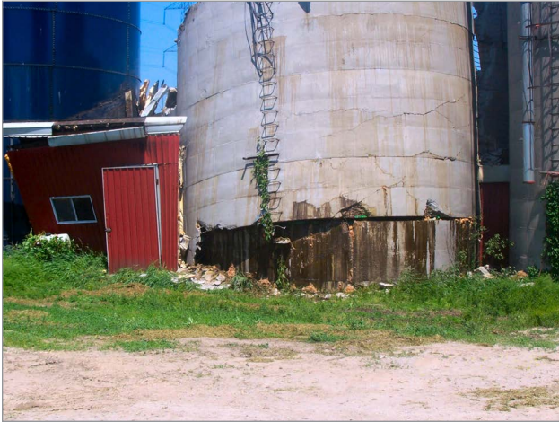
Figure 2. Produire de l'ensilage mi-fané ou de l'ensilage de maïs à partir de végétaux ayant une trop forte teneur en eau amène l'écoulement de liquides corrosifs qui affaiblissent et endommagent les silos. (Photo offerte par : Thomas P. Rylett Ltd., ingénieur-conseil en structures)
