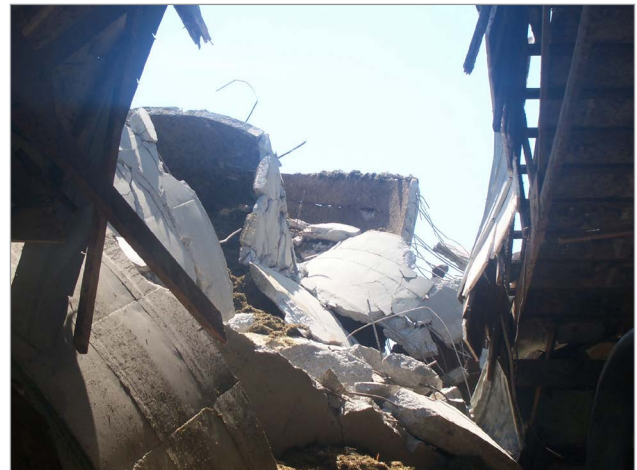
Figure 1. L'effondrement d'un silo peut entraîner des pertes de vie et causer des dommages considérables aux structures touchées. (Photo offerte par : Thomas P. Rylett Ltd., ingénieur-conseil en structures)
