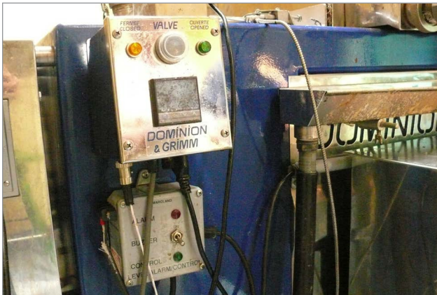
Figure 11. Boîte de commande ou alarme reliée au capteur et coupant automatiquement l'alimentation électrique du brûleur à mazout lorsque le niveau de sève dans la bassine à ondulations est trop bas.
