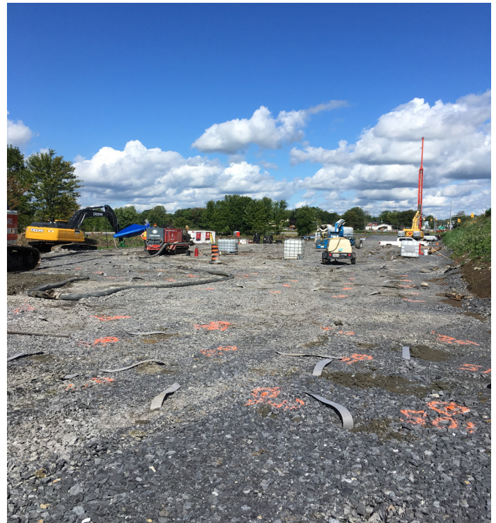
Installation d'IR au remblai sud. Les marques orange indiquent les emplacements relevés pour les IR et les drains verticaux.
