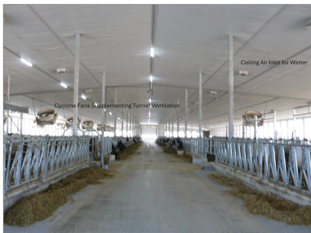
Figure 8. Ventilation longitudinale dans une étable avec des ventilateurs cycloniques.
