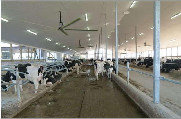
Figure 11. Ventilateurs HVLS au-dessus des logettes pour le refroidissement.
