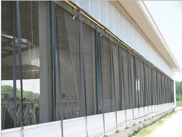
Figure 3. Entrée d'air sur les parois latérales avec un grillage aviaire.
