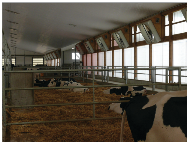
Figure 6. Étable avec un système de ventilation hybride.
